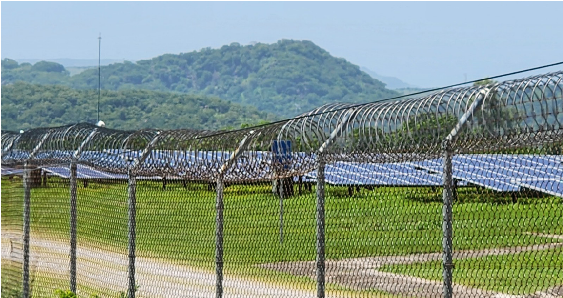
Paneles solares, parte del proyecto Agua Fría, en Nacaome, Honduras. Crédito: Criterio.hn
